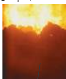
Unité de valorisation énergétique (four-chaudière)
