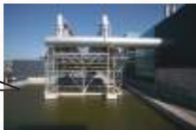
Traitement des eaux
